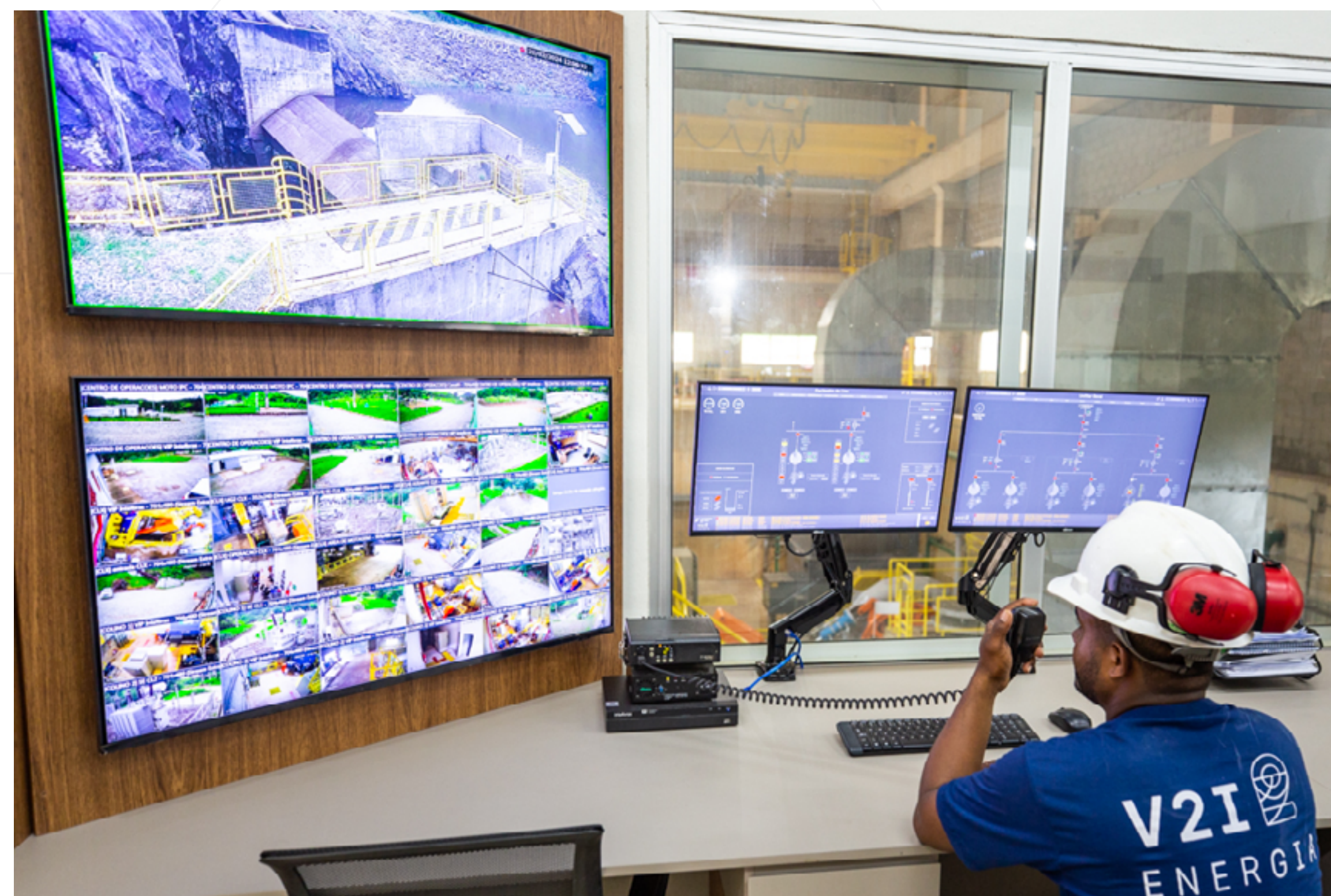
Colaborador na sala de controle operacional - ESPRA
