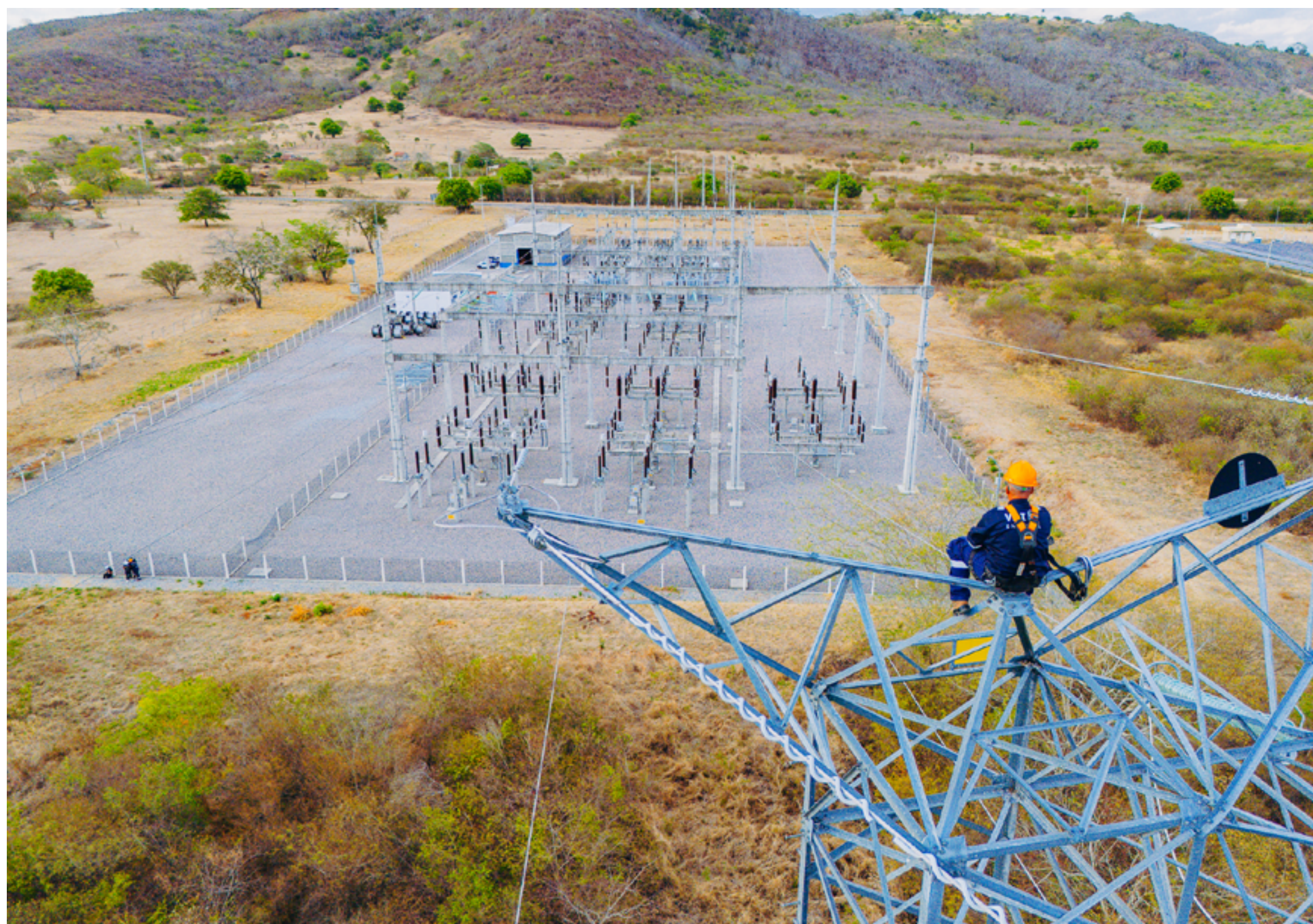
Arcoverde Transmissão de Energia
